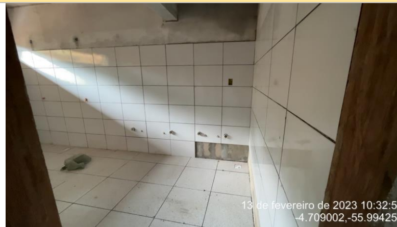
1 – Revestimento cerâmico, piso cerâmico, pontos de água fria e água servida. Selador acrílico em paredes e caixilhos para recebimento de portas
